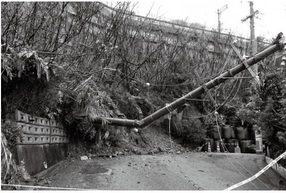
地すべり発生直後の現場(10月5日)
