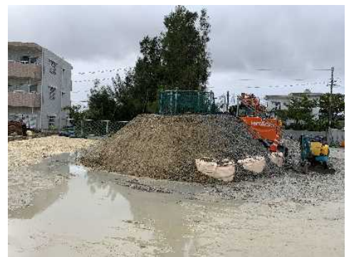
▲強固な不発弾処理用防護壁 (ライナープレート)
