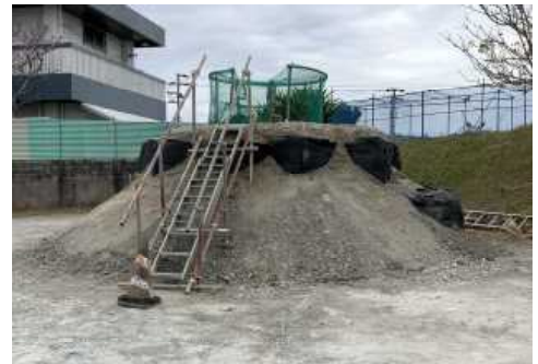
▲強固な不発弾処理用防護壁 (ライナープレート)
