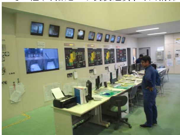
↑ 那覇・南風原クリーンセンター制御室
