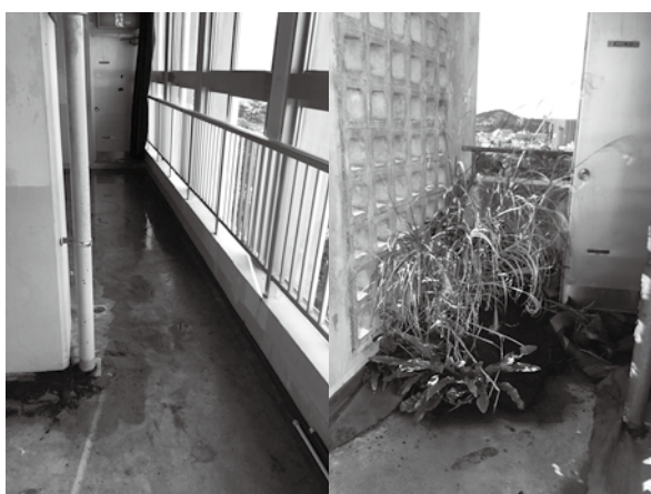
水漏れしているギャラリー。ドアの外側は雑草が生えている
