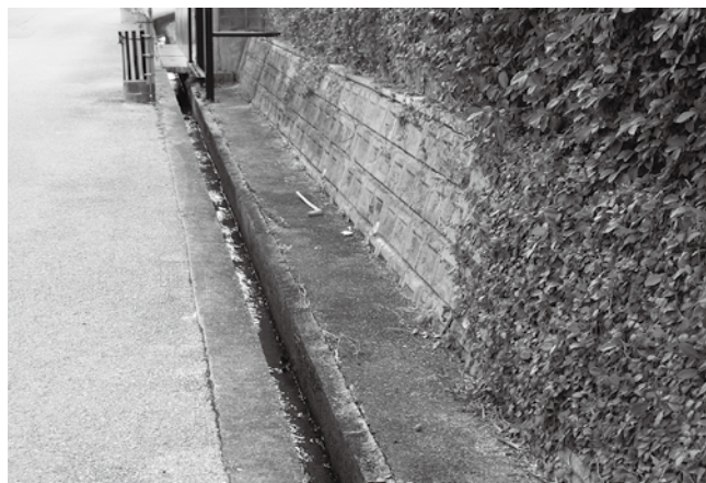
真和志高東側の側溝の様子。道路と側溝に段差がある
