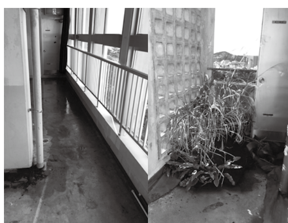
水漏れしているギャラリー。ドアの外側は雑草が生えている
