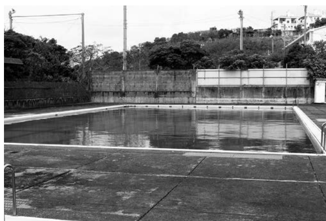
北丘小学校プールの現状
