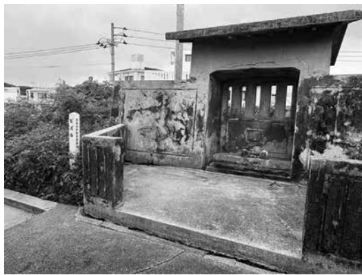
拝所「ビズル」 津嘉山児童館向きに、傾いて亀裂が入っている
