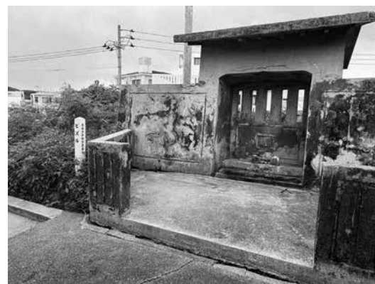
拝所「ビズル」 津嘉山児童館向きに、傾いて亀裂が入っている
