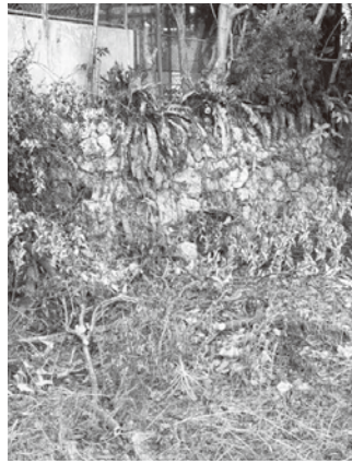
崩れかけた石積みの擁壁
