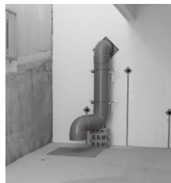
設置された排水管
