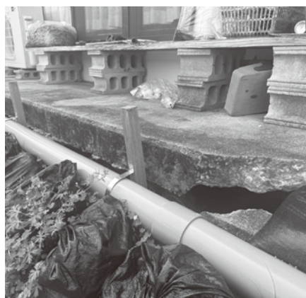
河川工事の影響と思われる地盤沈下
