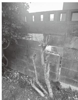
河川工事の影響と思われる地盤沈下
