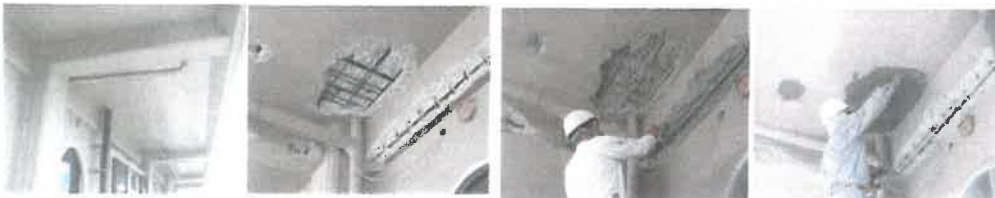
①工事前 コンクリート浮き、落下の危険性がある。 ②剥離改修 ③錆止め塗布作業 ④埋め戻し状況
