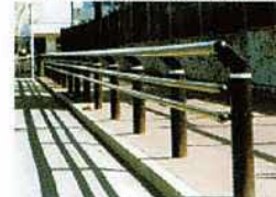
・防護柵（ｶﾞｰﾄﾞﾊﾞｲﾌﾞ）
