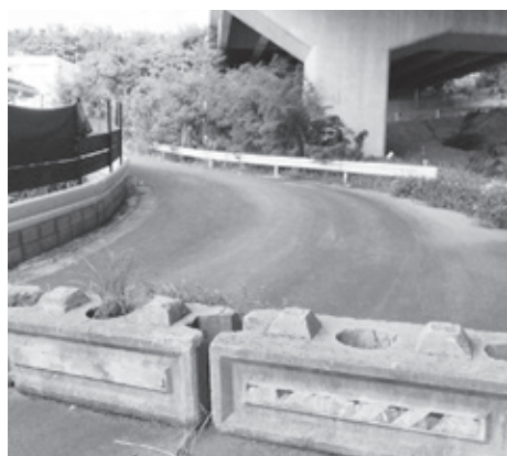
町道113号線 中断箇所
