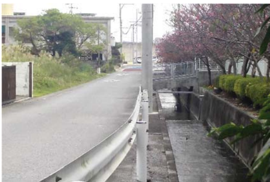
⑤安全対策がなされていない水路(町道 170 号線)
