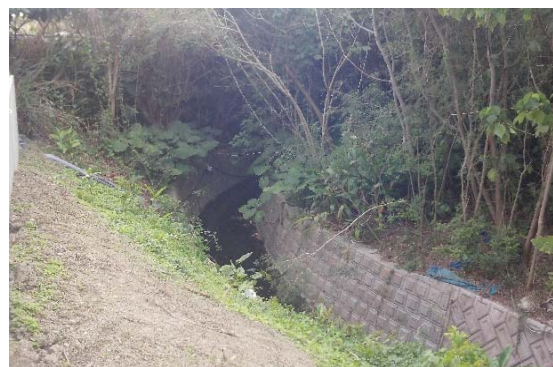
⑦大雨時に増水がみられる水路(字山川地内)
