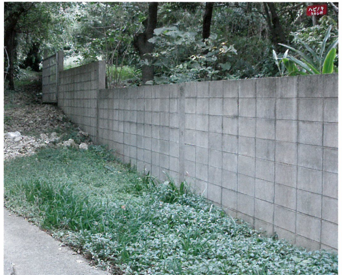
ハブの侵入を防ぐブロックべい
