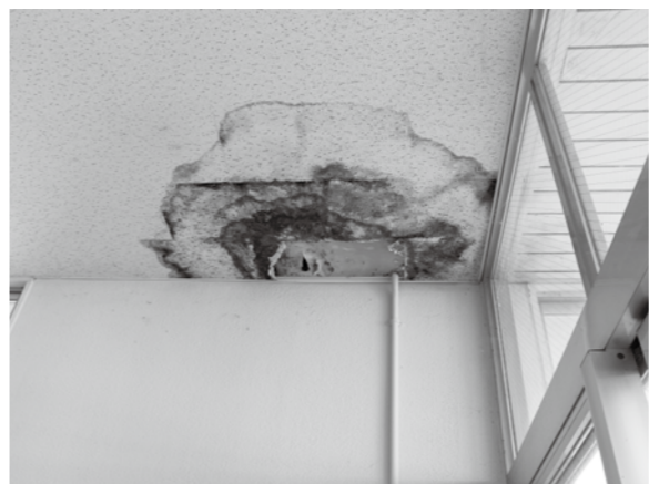
東部消防庁舎内、ところどころで雨もりが発生している天井。
