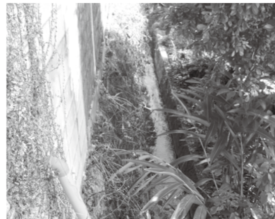
喜屋武8番地横の排水溝
