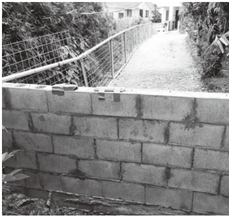
里道に積まれたブロック塀
