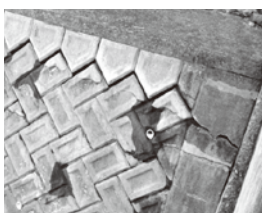
擁壁の亀裂が広がっている
