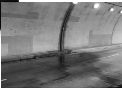
水漏れしているトンネル内部
