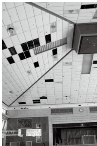
体育館天井にいくつか穴が空いています。
