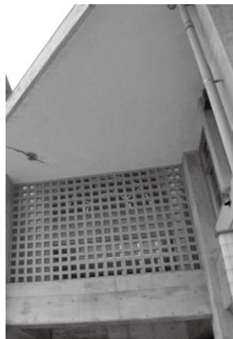
剥がれや亀裂が入った箇所があります。
