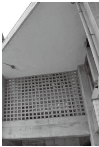
剥がれや亀裂が入った箇所があります。
